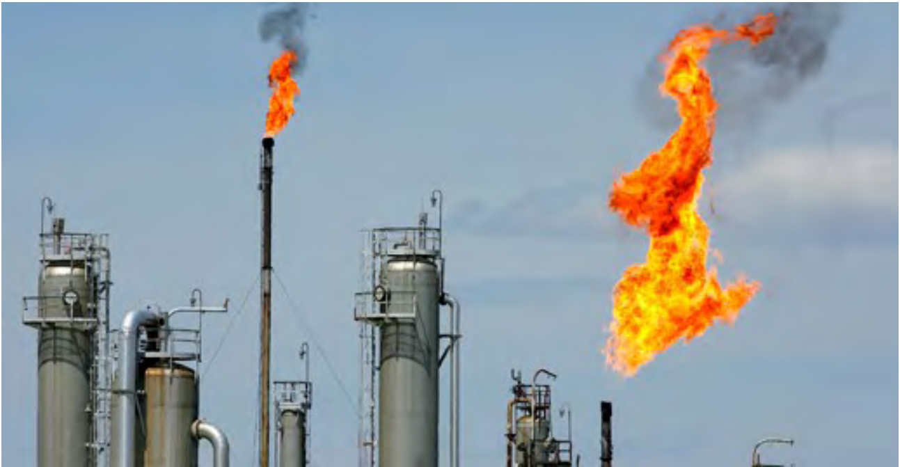
FIGURA 43 - DISPOSITIVO FLARE QUEIMA O EXCESSO DE GÁS E REDUZ O RISCO DE EXPLOSÕES
