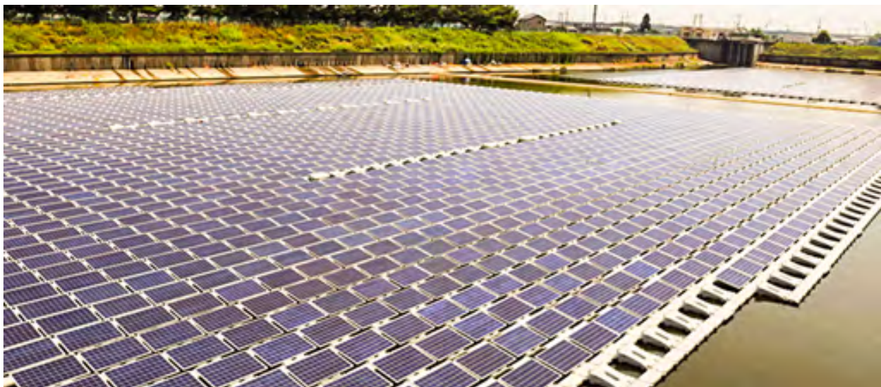
FIGURA 7 - USINA SOLAR FOTOVOLTAICA FLUTUANTE, NO RESERVATÓRIO DE SOBRADINHO NA BAHIA.
